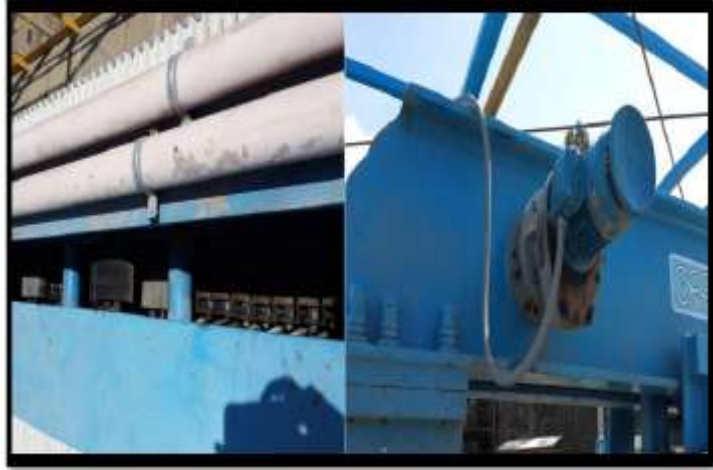
Figura33: Sistema de transporte de placas FUENTE: Manual de filtro prensa
